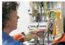
Comprobación de aislamiento en un cuadro de distribución
