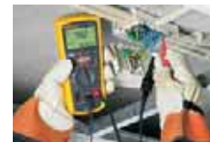
Comprobación del cableado en una pequeña caja de distribución: todo en el mismo sitio
